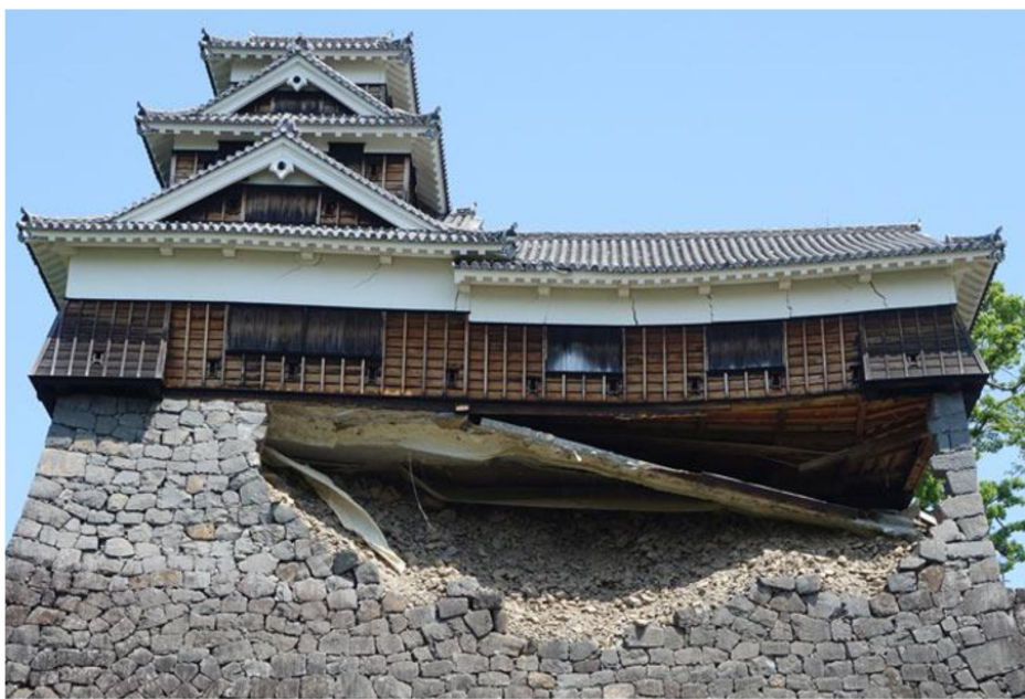
本震後に残った1本の石垣で飯田丸五階櫓を支える様子。
